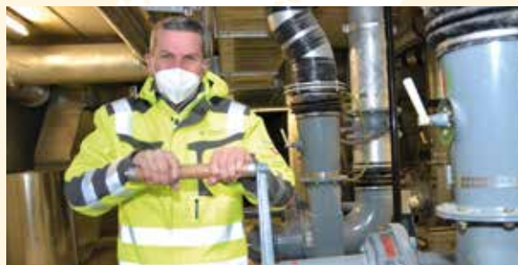
Ein überlebenswichtiger Raum der Anlage ist die Lüftungszentrale. Von diesem Raum wäre die nötige Luft in den Schutzraum gepumpt worden, Schwabestofffilter und Sandfilteranlagen dienen dazu, die Luft zu reinigen. Bei Stromausfall könnten die Pumpen händisch betrieben werden. Das funktioniert übrigens heute noch, wie Wolfgang Sonnhütter beweist.
