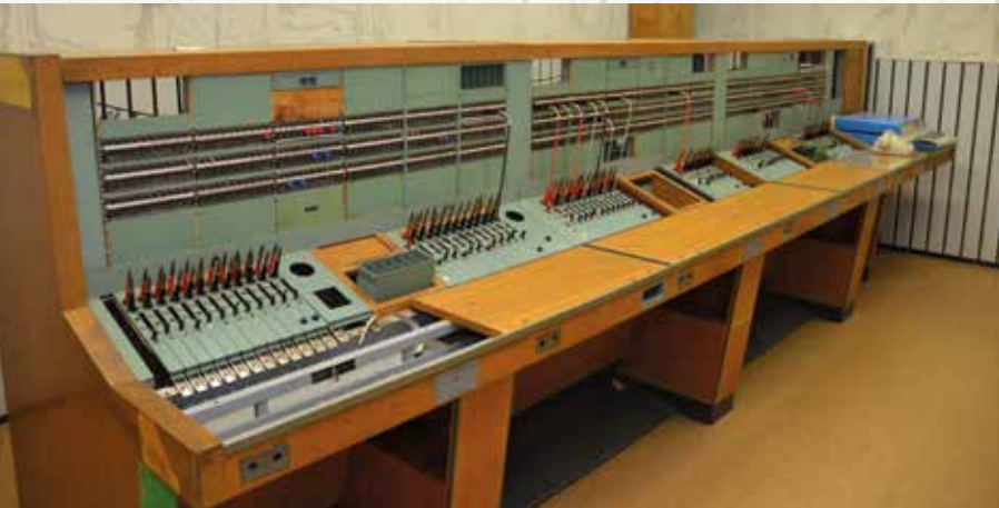
Blick in den Fernmelderaum. An der Fernsprecheinheit haben sechs Personen gearbeitet.
